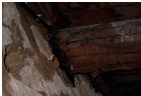
Umidità di condensa
