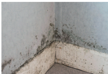
Umidità di risalita
